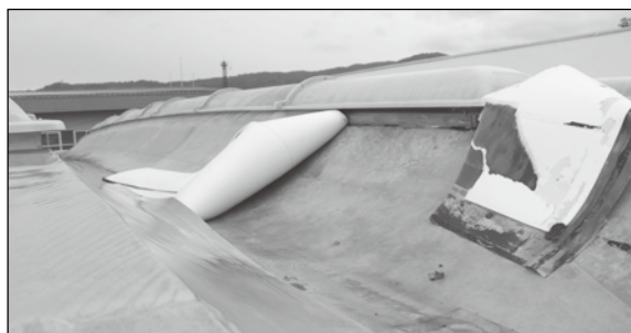
台風15号による温水プール屋上の被害状況
